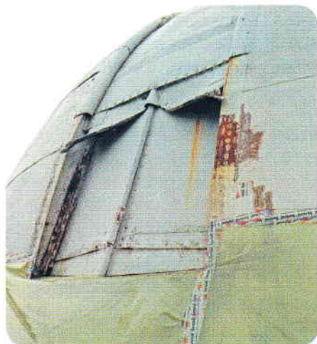
Eine Sanierung war aufgrund der zahlreichen Roststellen notwendig.
